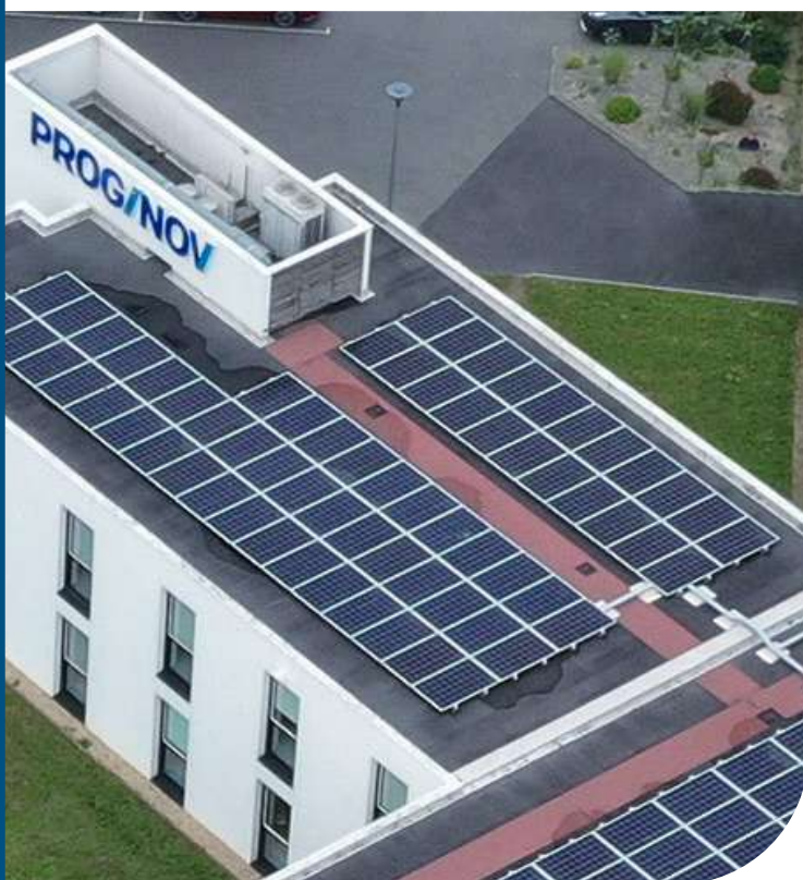
Image : centrale réalisée en technique courante par EDF EnR sur le toit de Proginov (La Chevrolière - 44) avec le système de fixation Roof-Solar Bitume de Dome Solar.
