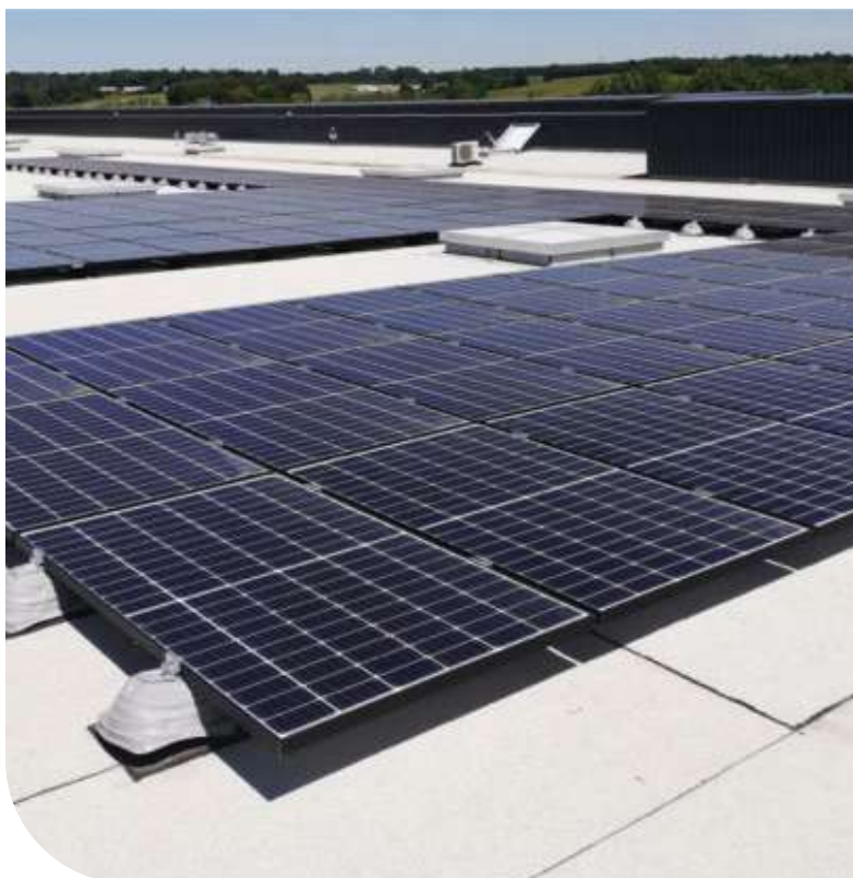
Image : centrale en toiture réalisée en technique courante par Emeraude Solaire.
