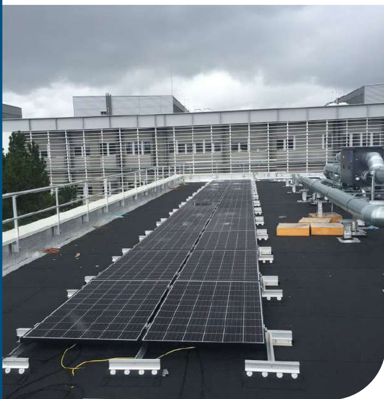
Image : centrale en toiture réalisée en technique courante par JCM Solar
