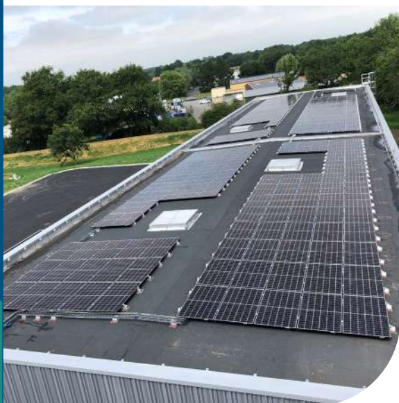
Image : centrale réalisée en technique courante par le groupe IEL sur le toit de Radian (Bouaye - 44) avec le système de fixation Roof-Solar Bitume de Dome Solar.
